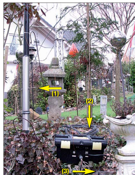
Bild 1: Glasfibernast im Standrohr mit Schraube (1); hinter der Anpassbox liegt der Kondensator (2) aus RG213. Die Radials sind an der von Laub teils verdeckten Edelstahlplatte (3) angeschlossen. Fotos: DK5WL
