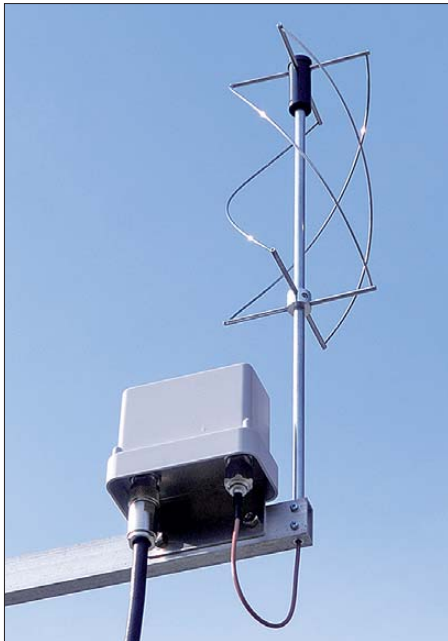
Bild 2: Ansicht der Antenne am Ausleger mit Mastvorverstärker
